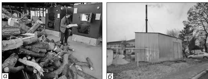
Рис. 11.11. Варіанти котельні на дровах: а – котельня на дровах у м. Ірпінь; б – блочно-модульна котельня потужністю 400 кВт (Львівська обл., м. Золочів, вул. Гайдамацька)
