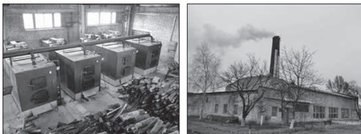
Рис. 11.12. Котельня на дровах встановленою потужністю 4 МВт (реконструкція котельні військової частини, Львівська обл.)
