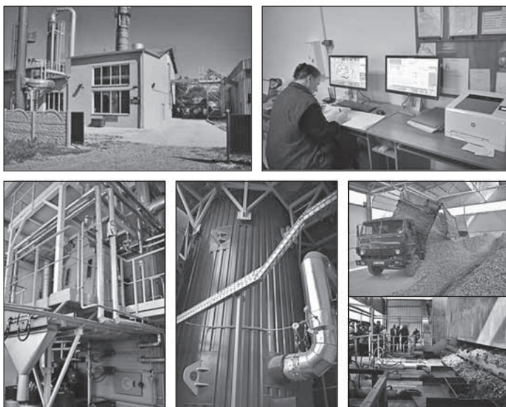
Рис. 11.18. Котельня потужністю 4 МВт на деревній трісці ДМП «Івано-Франківськтеплокомуненерго» у м. Івано-Франківськ ( https://zaholovok.com.ua/yak-ivano-frankivsk-modernizuje-svii-energetichnii-sektor-i-ekonomit-groshi )
