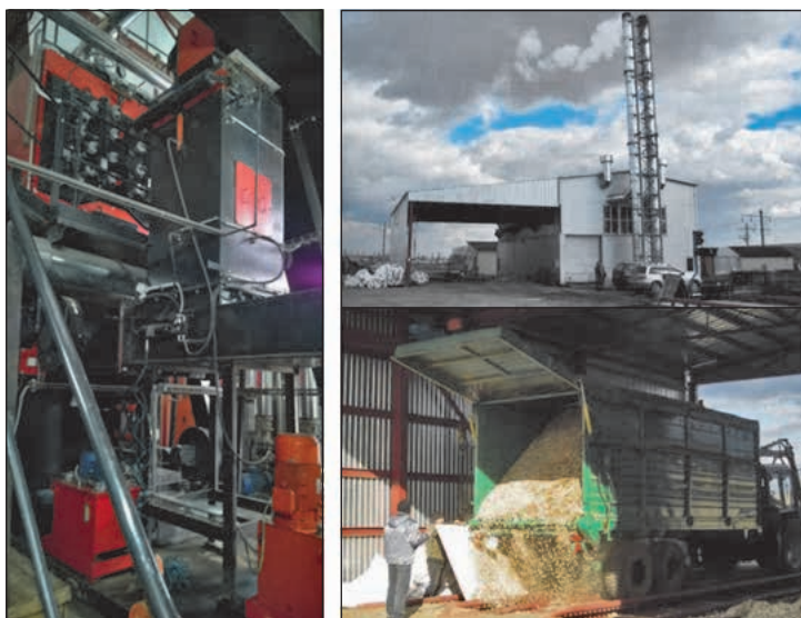
Рис. 11.21. Котельня на біомасі для опалення теплиць потужністю 7 МВт (ТОВ «Камелія», 2014 р.). Установлено 2 котли «Крігер» тепловою потужністю по 3,5 МВт. Паливо – тріска, гранули
