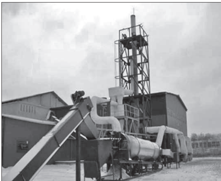
Рис. 11.9. Котельня ДМП «Івано-Франківськтеплокомуненерго», м. Івано-Франківськ, вул. Юності, 11а
